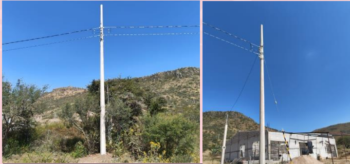
AMPLIACION DE ELECTRIFICACION EN SAUZ DE ARRIBA
