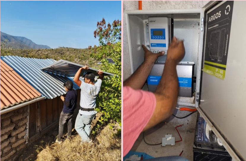
MODULOS FOTOVOLTAICOS EN EL SABINO
